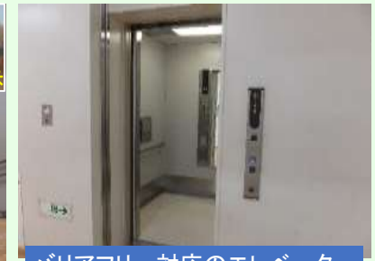
バリアフリー対応のエレベーター
